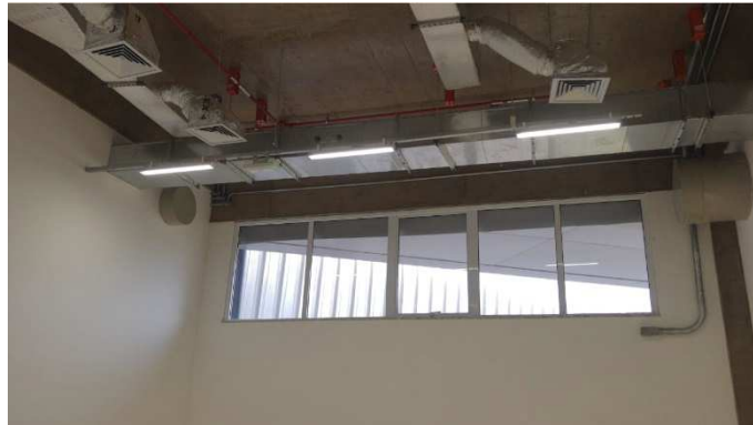
Figura 10 – Foto da sala 439E2 mostrando duto interrompido
